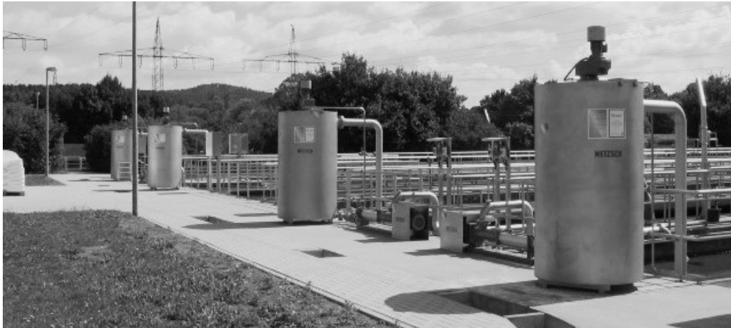
Abbildung 4: 300 000EW Anlage mit 4 Strassen und 4 Reaktoren
